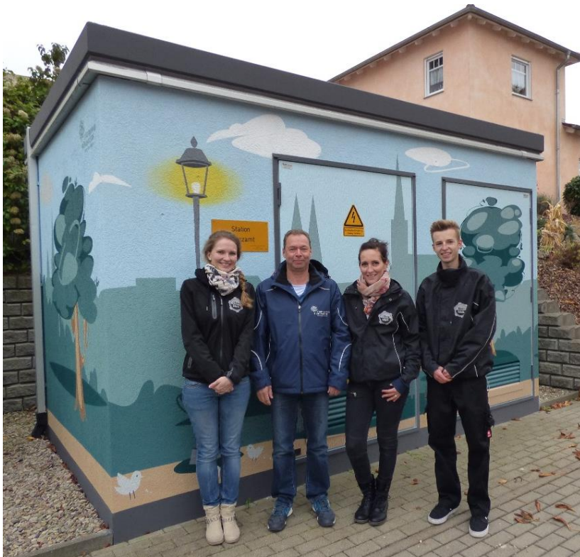
Silvia Galek, Julia Stollberg und Leon Guckuk (v.l.n.r., alle Fa. Ideenfabrik) übergeben Thomas Hartl (2.v.l., Bereichsleiter Strom, Stadtwerke Mühlhausen) die neu gestaltete Trafostation am Finanzamt.
